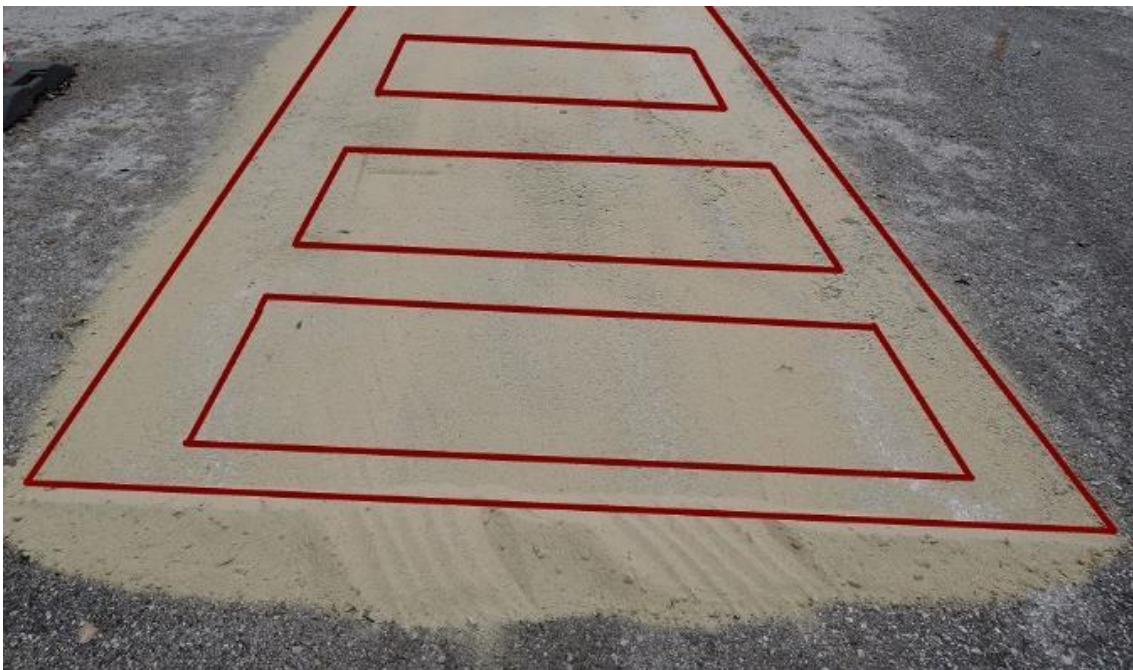
Abbildung 68: Feinsand nach Räumfahrt
